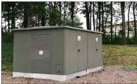
Transformatorstation brevid skolskogen till Trädgårdsstadens skola, etapp 2.
